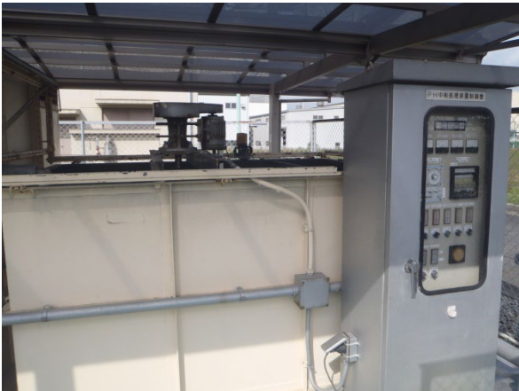
中和槽と制御盤
