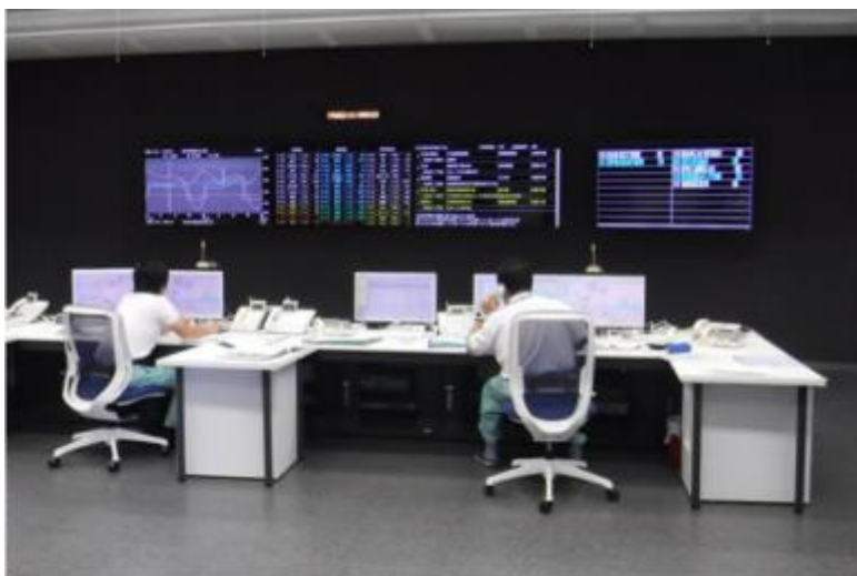
中央制御管理室 (テレメータ・テレコントロールシステム)
