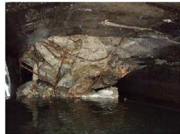
広島県送水トンネル崩落事故
