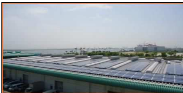
図 19 臨海部の屋根上太陽光発電設備
