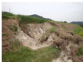
農地の法面崩壊
