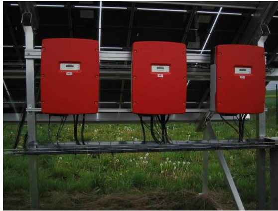
写真 1.4-2 パワーコンディショナー（設置イメージ）
