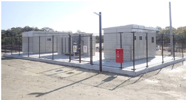
写真 1.4-3 受変電設備（設置イメージ）
