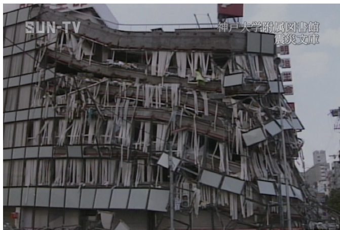
取材映像「倒壊した菱明ビル」より(神戸市兵庫区) 提供:サンテレビジョン
